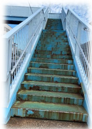
(老朽化が進む日の出町歩道橋)
